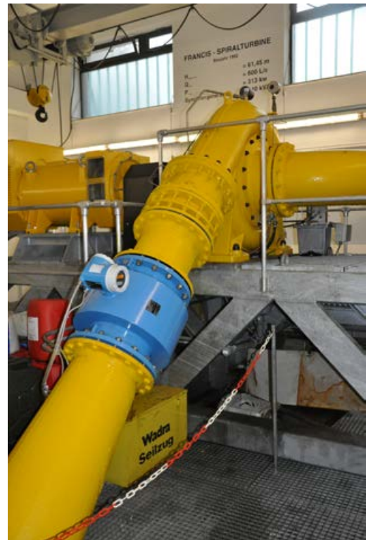
Wasserkraftanlage Primstalsperre Nonnweiler
